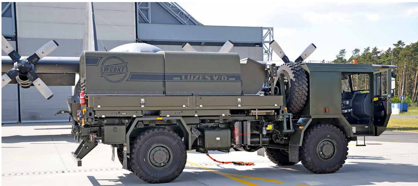
Pierwszy zasilacz elektroenergetyczny LUZES V/D serii V na podwoziu samochodu ciężarowego Jelcz 442.32., który pod koniec maja trafił do 33. Bazy Lotnictwa Transportowego w Powidzu.
